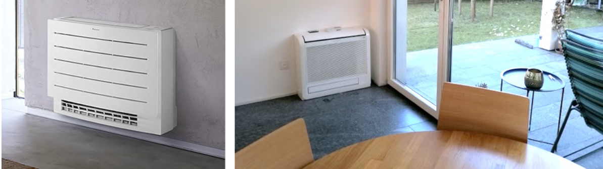
Abbildung 5: Truhengeräte (Quelle: links Daikin, rechts eigene Aufnahme)
