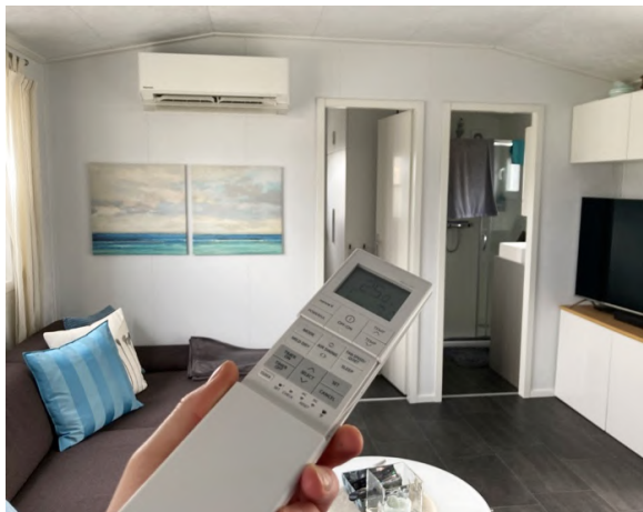
Abbildung 25: Innenteil des Klimageräts
