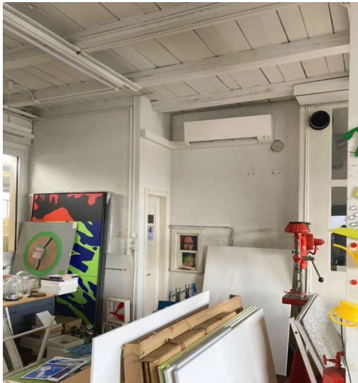
Abbildung 33: Innengerät im Atelier. Darunter stand bisher eine Öl-Umluftheizung.
