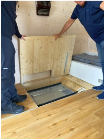
Abbildung 18: Das Innenteil des Klimageräts, ein sog. Kanalgerät, ist in den Fussboden eingelassen und erwärmt die Luft im darunter befindlichen Hohlraum.
