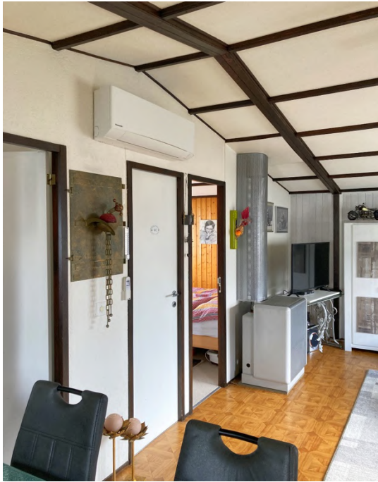
Abbildung 29: Wandgerät der Klimaanlage im Vordergrund, alte Ölheizung im Hintergrund
