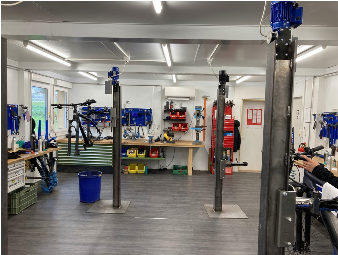
Abbildung 12: Gebäude 1 (Werkstatt). Das Innenteil der Marke Daikin verfügt über eine ausreichende Heizleistung, die Werkstatt mit einer Fläche von 80 m 2 zu erwärmen.
