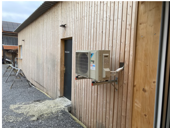
Abbildung 9: Gebäude 1 (Werkstatt). Das Aussengerät befindet sich am Hintereingang zur Werkstatt. Mögliche Geräusche spielen auf dem Werksgelände keine Rolle.
