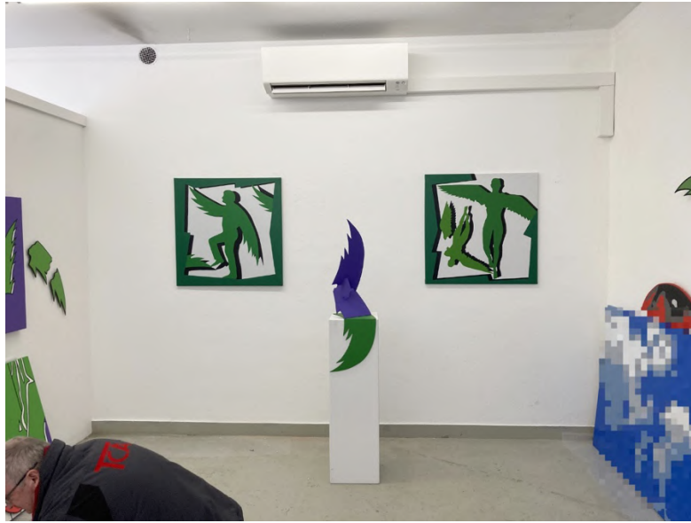
Abbildung 35: Mit dem Innenteil ist erstmals ein aktives Heizen des Ausstellungsraums möglich. Zu sehen links vom Wandgerät die kleine Rohröffnung, welche früher Warmluft vom Nebenraum zugeführt hat.
