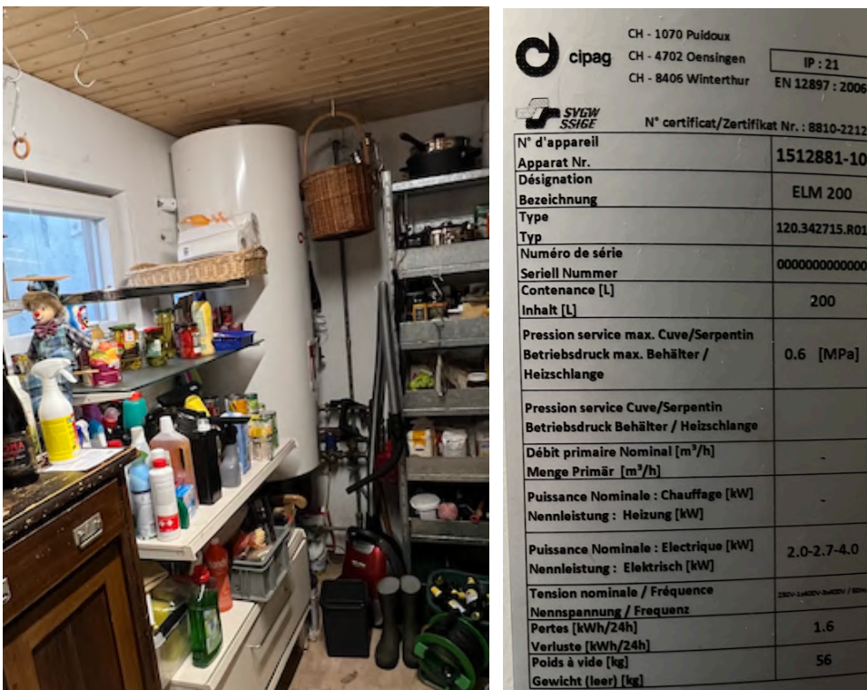
Abbildung 70: Elektroboiler mit Typenschild welcher durch Wärmepumpenboiler ersetzt werden soll
