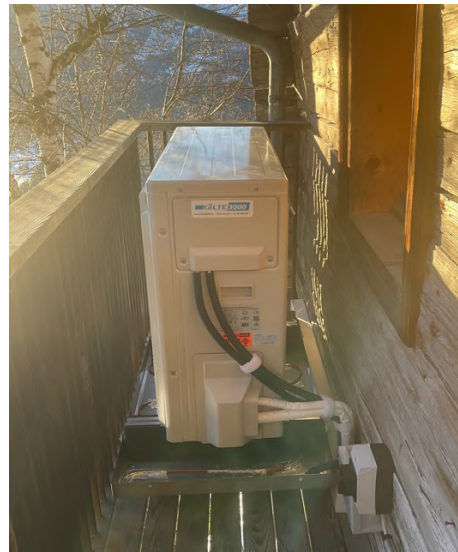
Abbildung 63: Aussenteil des Klimagerätes
