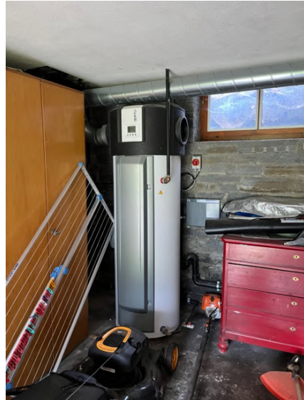
Abbildung 49: Wärmepumpenboiler zur Warmwasserproduktion im Keller
