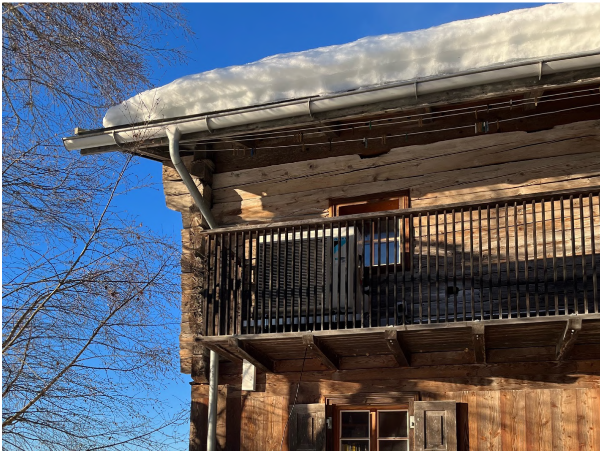
Abbildung 64: Aussenteil links auf dem Balkon
