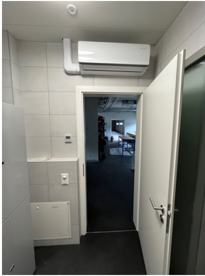
Abbildung 38: Inneneinheit D17 (2.2 kW Heizleistung) in der Umkleidekabine
