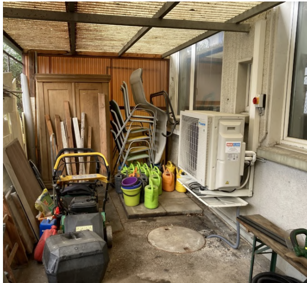
Abbildung 34: Platzierung des Aussenteils im Hinterhof mit Schlauchführung für Kondenswasser in den Gully
